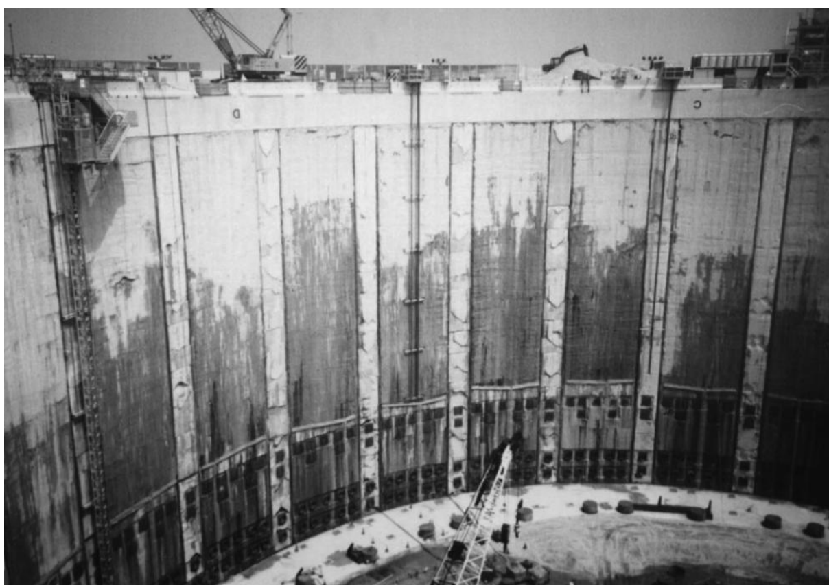
Rys. 2.10 Zarysowanie ścian szczelinowych szybu na Kawasaki Island
