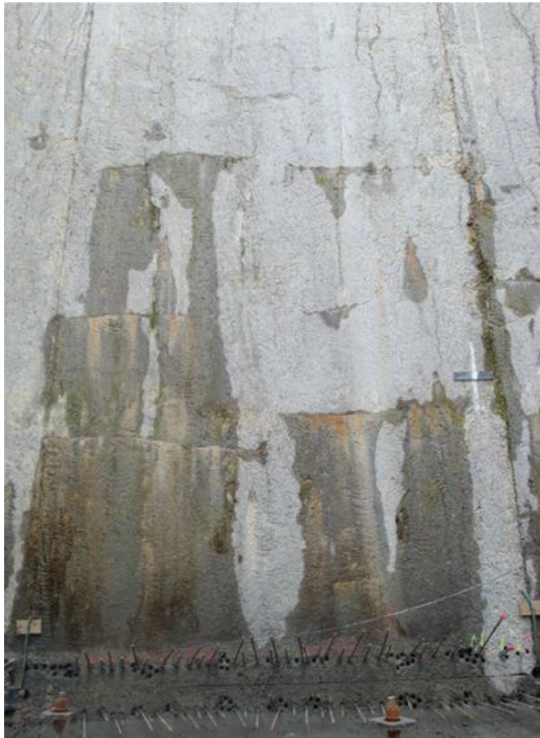
Rys. 2.9 Przykład ściany szybu z widocznymi zarysowaniami i zaciekami (fot. Soletanche Bachy)
