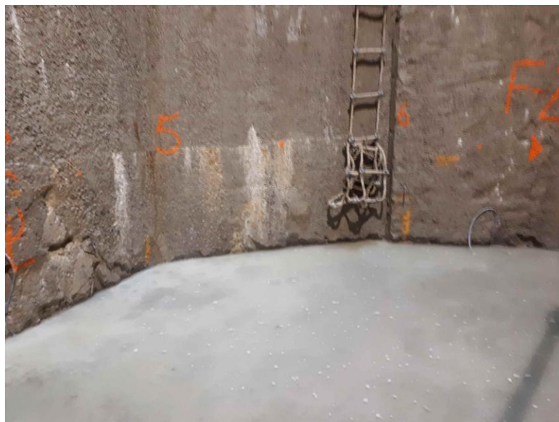
Rys. 2.13 Widok zarysowań i wysoleń (fot. Soletanche Polska)
